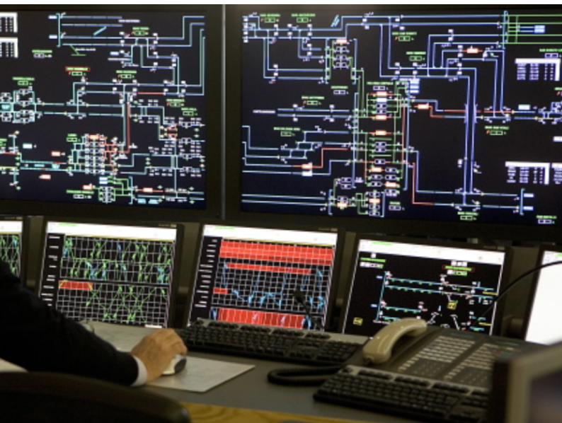
Fig. 3: Un control center equipaggiato con il sistema ICONIS con cui e' stato testato il sistema ECODRIVE
