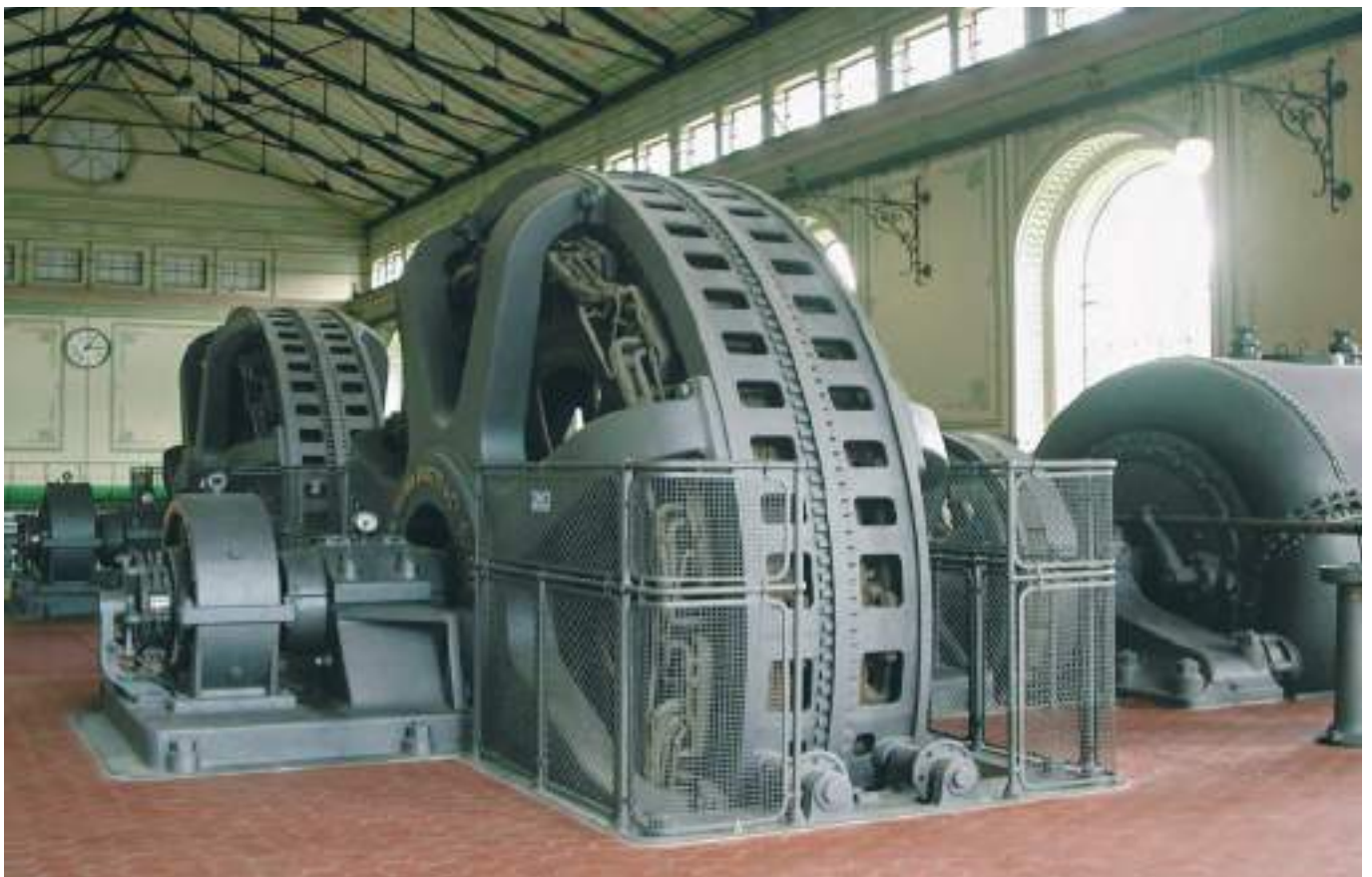
Veduta attuale della sala macchine della centrale idroelettrica di Paderno d'Adda "Angelo Bertini", 1898
